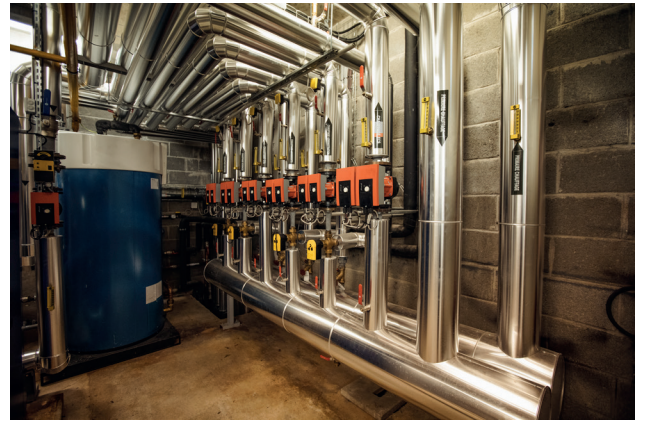
Canalisations et circulateurs de la chaufferie bois du collège de Mirande
